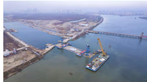
中交二航局投资建设的襄阳市东西轴线（襄江大道）鱼梁洲过江隧道为国内目前整体规模最大的内河沉管隧道
